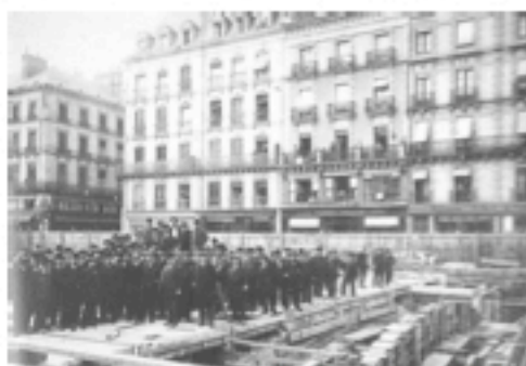
Visite du chantier par le maire J Janvier en 1912. Musée de Bretagne
